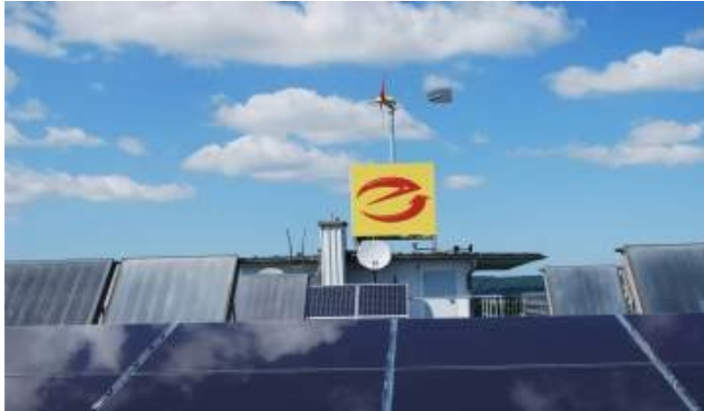
Photovoltaik und Solarthermieanlage
